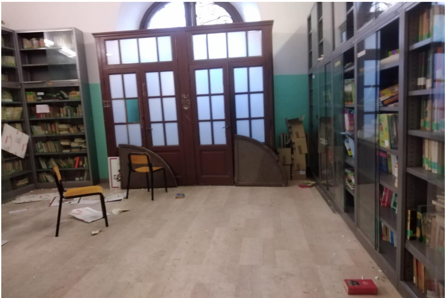
Vandalismo nei locali della biblioteca
