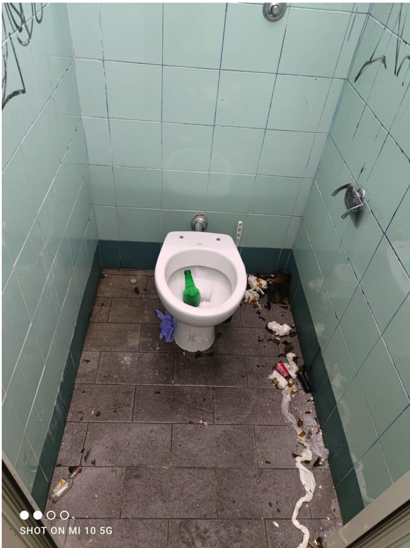
Vandalismo nei bagni
